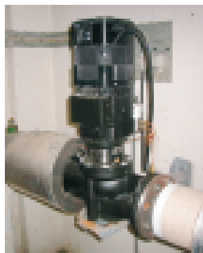
Figur 9.7. Regulerbar in-line pumpe med differensstryksensor
