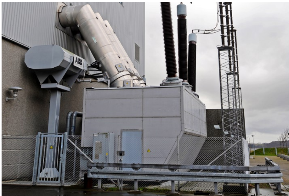
Skærbækværket. Nær generatorskinnerne, som fører strømmen ud fra generatoren, kan der være ganske store magnetfelter.
