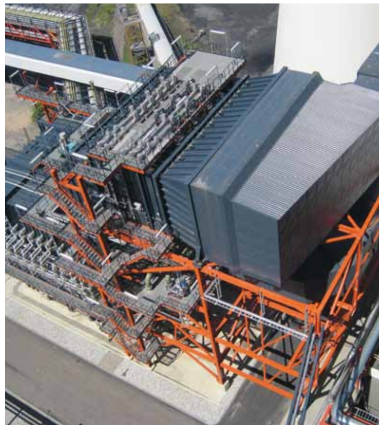
Afsvovlningsanlæg på Asnæsværket
