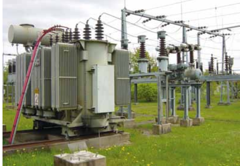
En 132/50 kV transformator.
